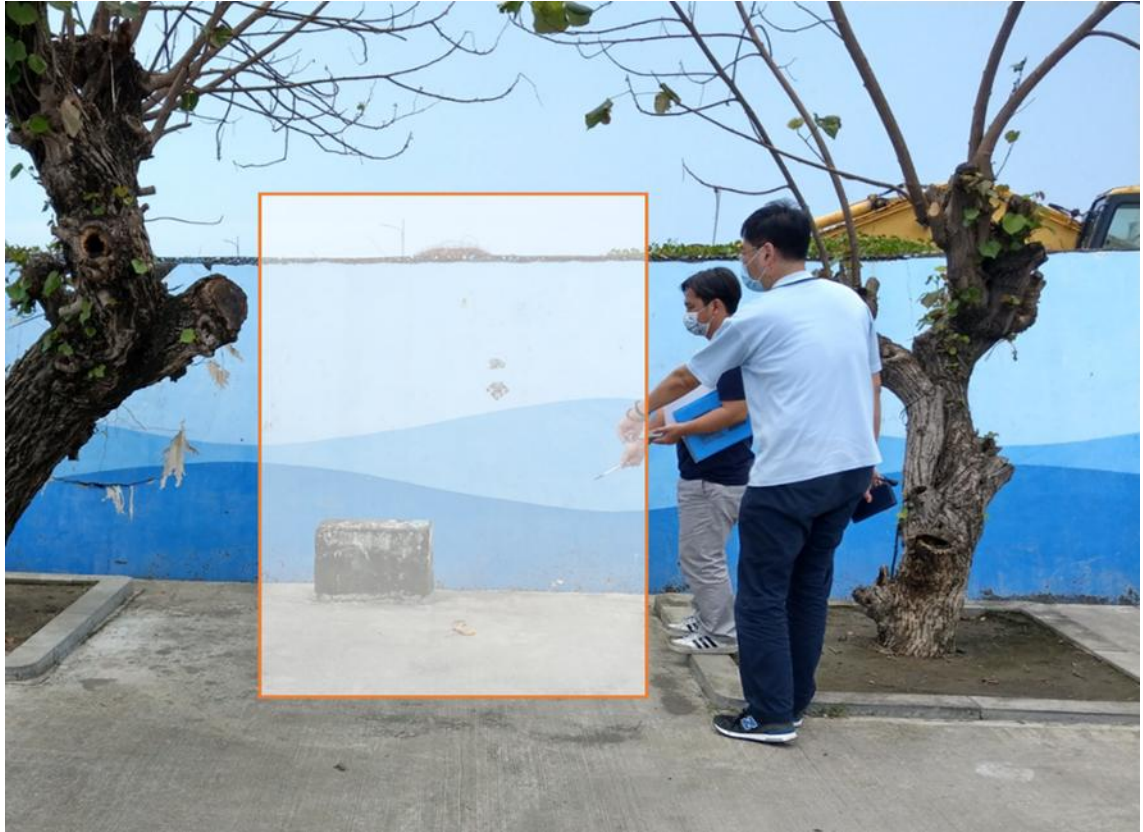
圖 60 中芸漁港景觀平台旁堤岸樓梯右側現場勘察示意圖 (5) 前鎮區
