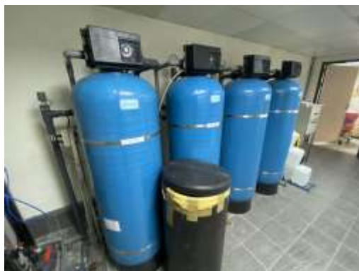
圖 4-2 RO 水前處理設備
