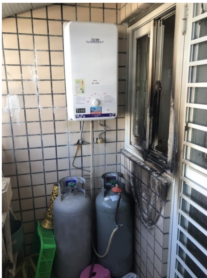
圖一、陽臺放置瓦斯桶及裝設燃氣熱水器，熱水器未依規定張貼施工標籤。
