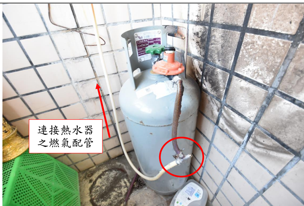
圖二、燃氣管材未經國家標準檢驗合格，管線未妥適固定。
