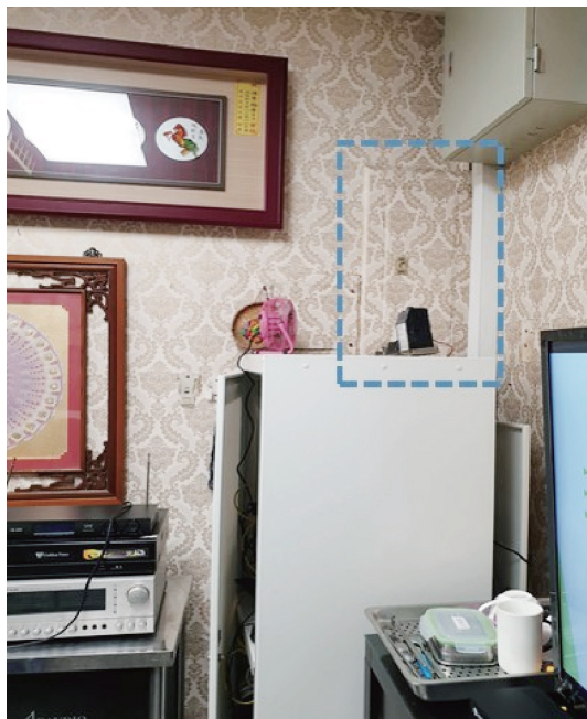
圖 2. 配電箱被遮擋之情形
