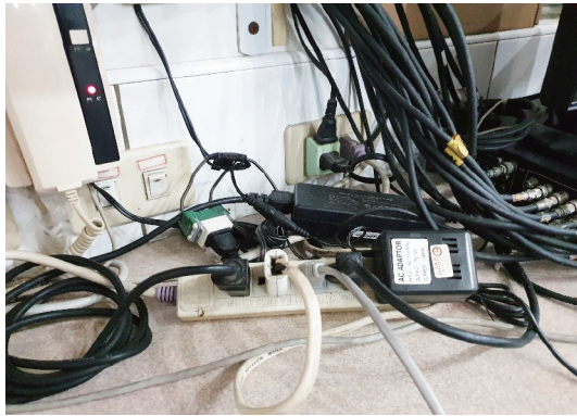
圖 3. 延長線不當使用之情形
