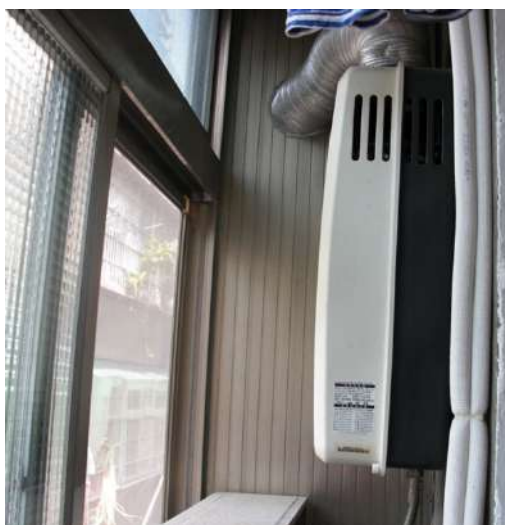
▲照片 5 半密閉自然排氣型（CF 式）熱水器之排氣管裝設錯誤
