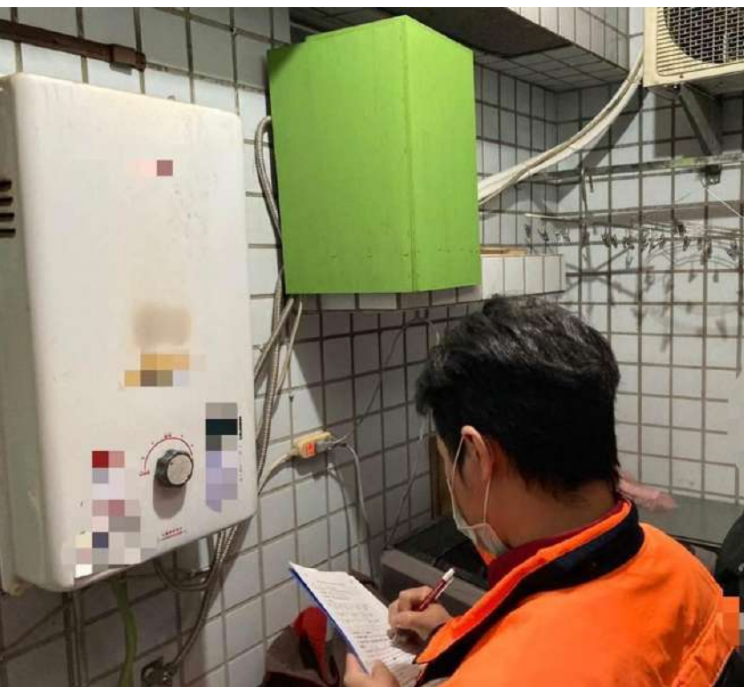
▲照片 1 為高雄市大寮區一氧化碳中毒熱水器裝設情形
