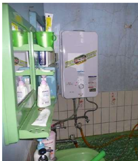
▲照片 4 半密閉自然排氣型（CF 式）熱水器未裝設排氣管
