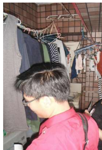
▲照片 6 燃氣熱水器安裝不當有產生一氧化碳中毒之虞（掛曬衣物）
