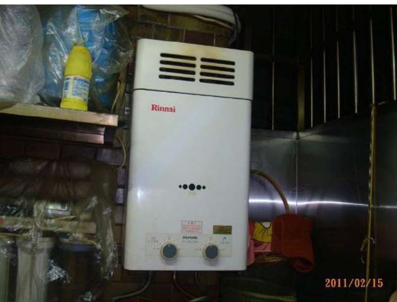
▲照片 3 屋外型（RF 式）熱水器裝設於室內
