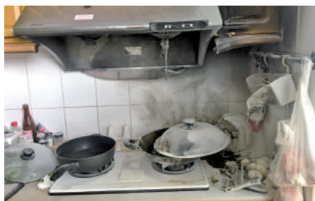
照片 7 爐具旁堆置易燃物
