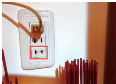
照片 2. 紅框處插座孔燒痕狀
