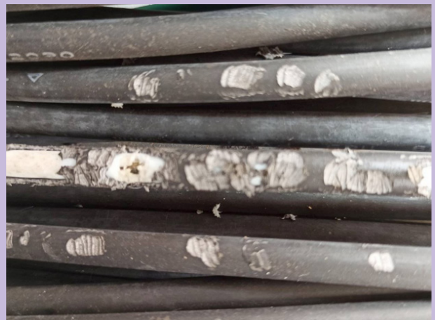
▲ 圖 8、永豐畜牧場直流電源線被老鼠啃咬 (資料來源：永豐畜牧場太陽光電系統業者提供拍攝提供)
