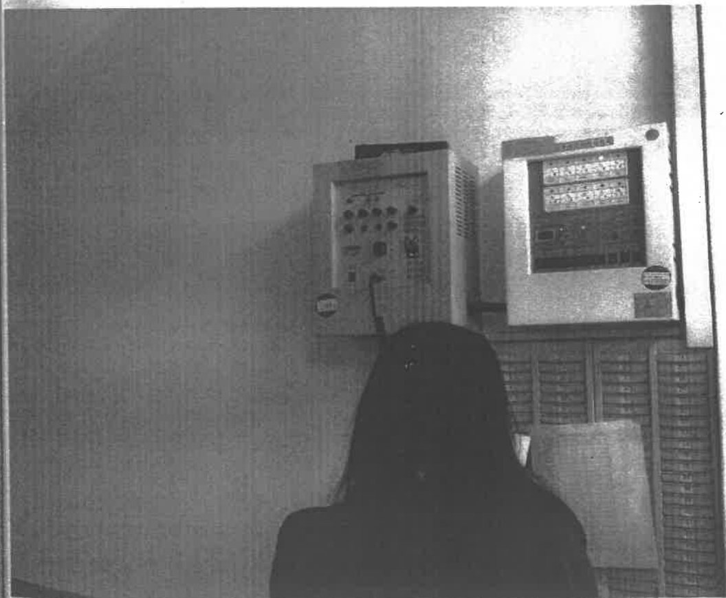
確認火災對內廣播、通報情形
