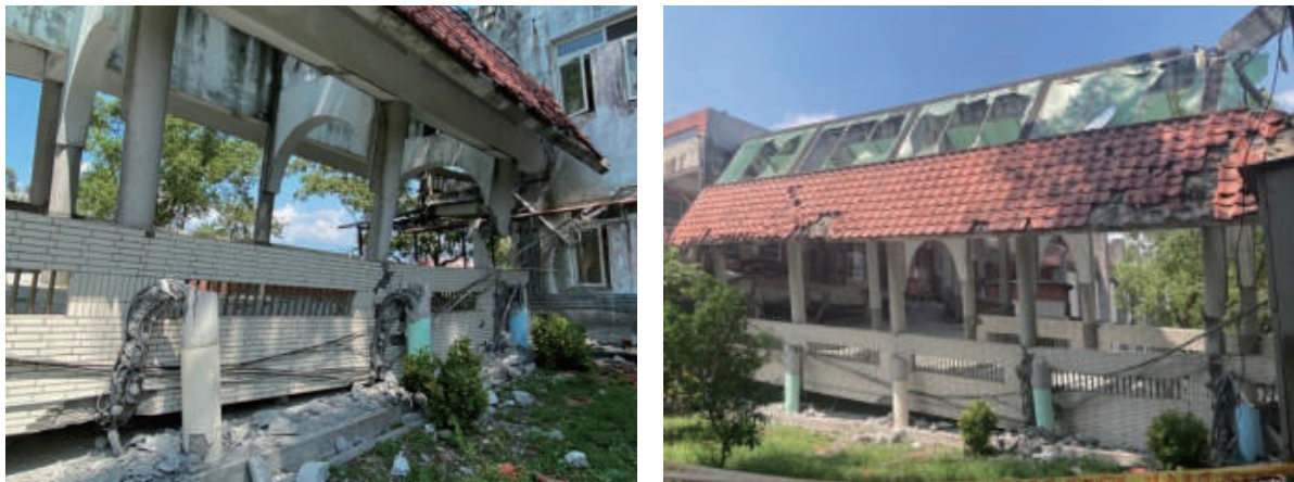
圖 4-91、111 年 9 月花蓮地震現勘春日國小通廊道倒塌情形
