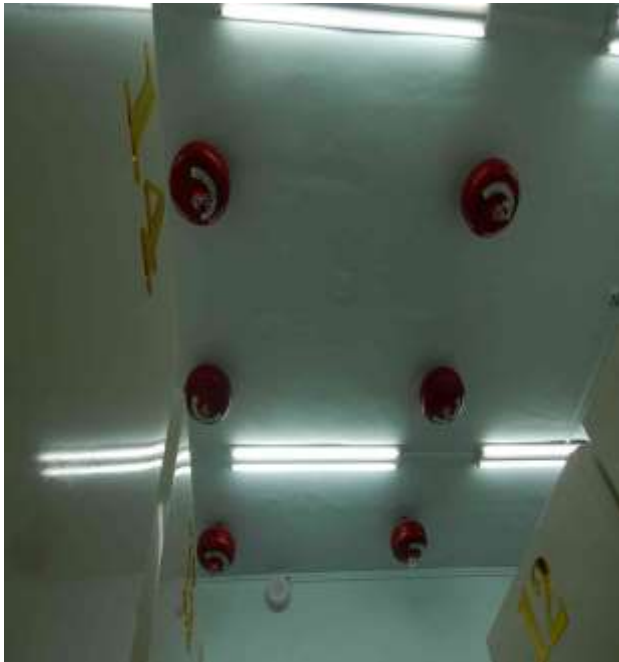
天花板式氣體滅火器
