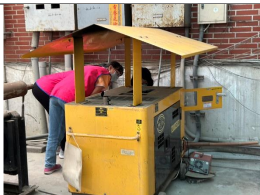
說明：大型柴油發電機教學與操作
