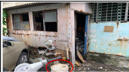
廢棄空屋堆滿垃圾及雜物，桶蓋已積水
