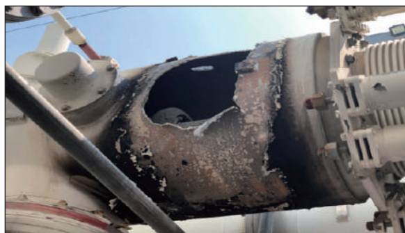
圖 1-10、3 月 3 日興達電廠設備故障，造成全臺大停電
