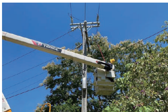
圖 3-5、跳電事故發生，台電盡全力排除異常，恢復正常供電
